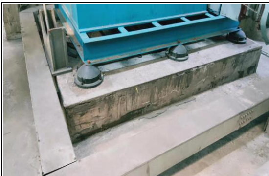
压缩机水泥底座
