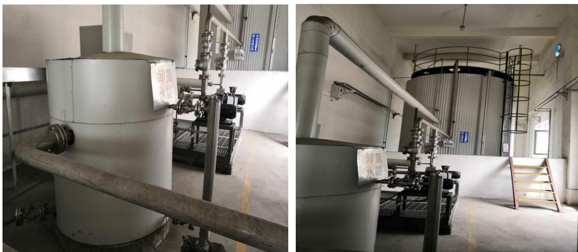
氨水泄罐区及管道
