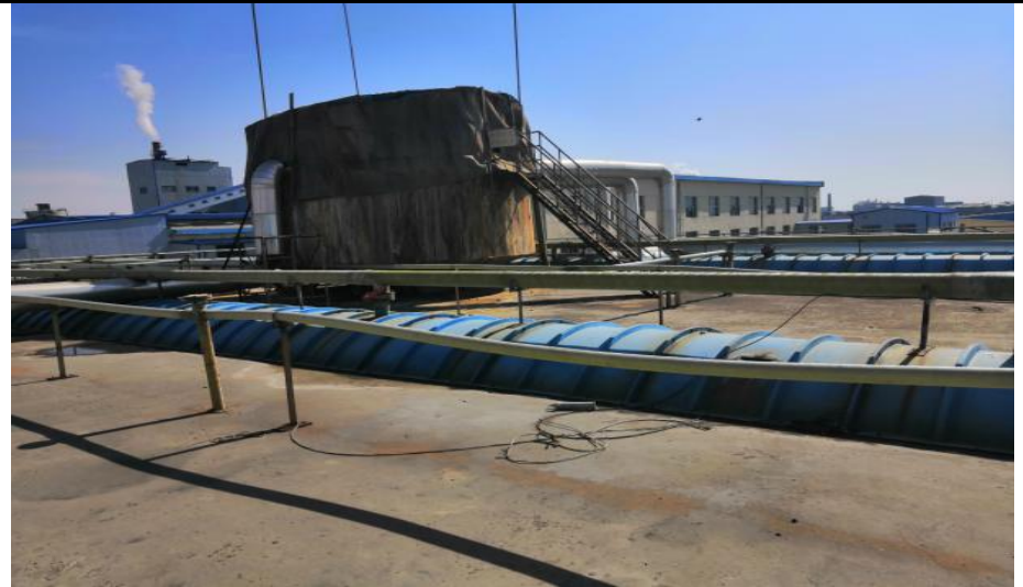
恶臭气体收集管道
