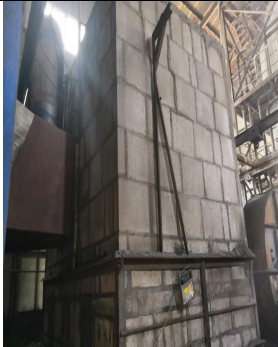
备用锅炉水膜除尘器
