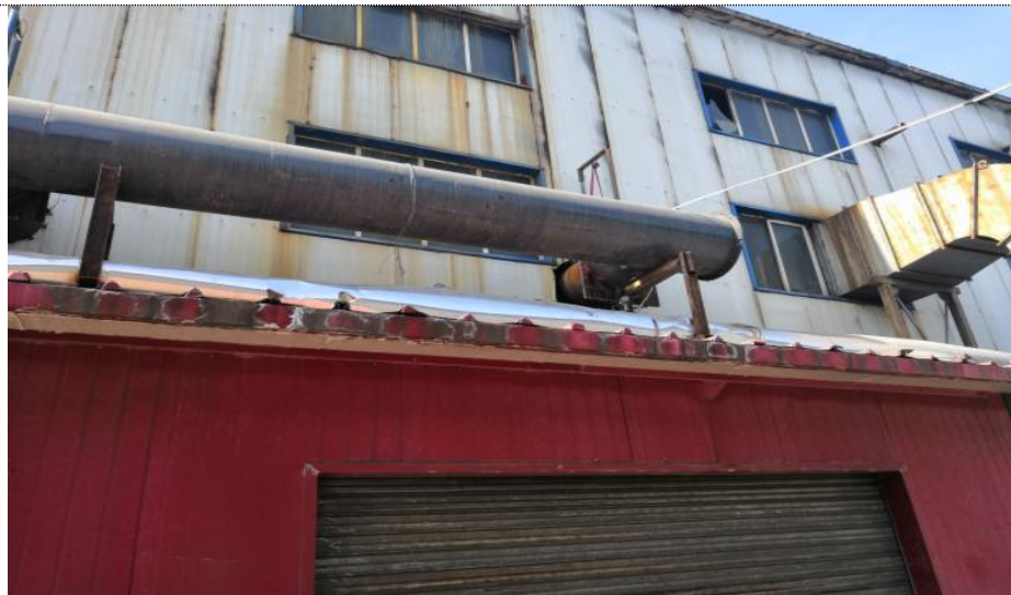
集水池、调节池、初沉池臭气进入锅炉房管道
