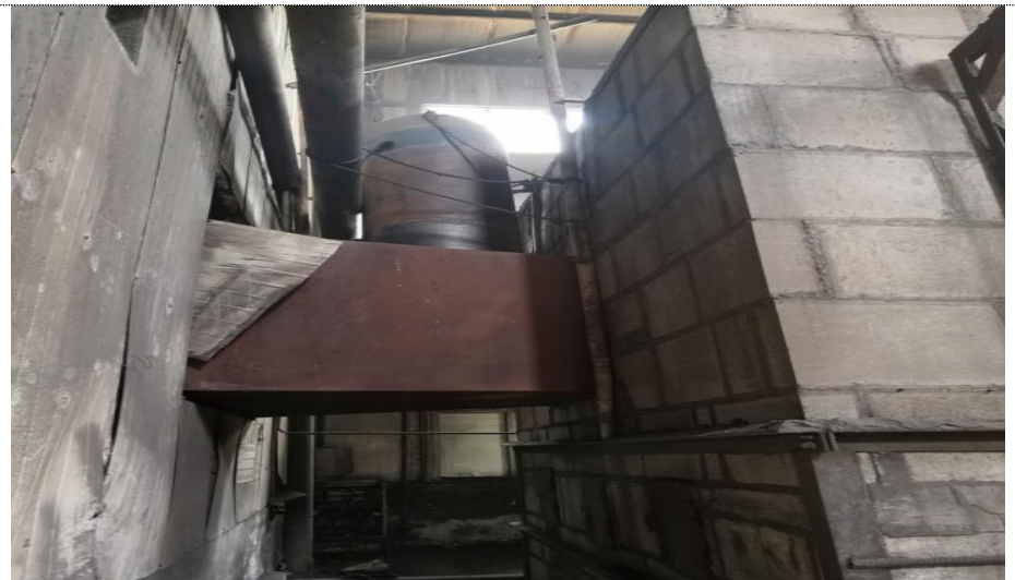
臭气管道进入锅炉房水膜除尘器前端处
