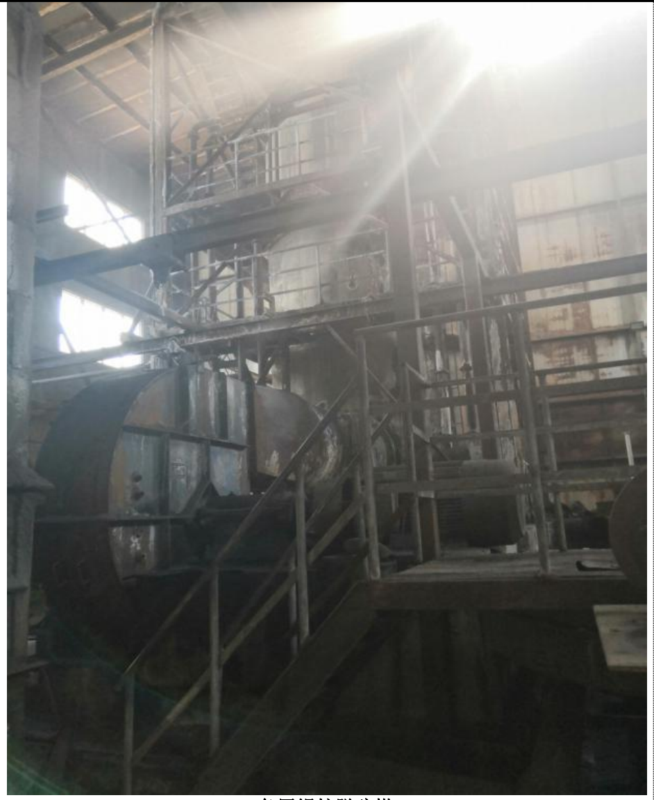
备用锅炉脱硫塔
