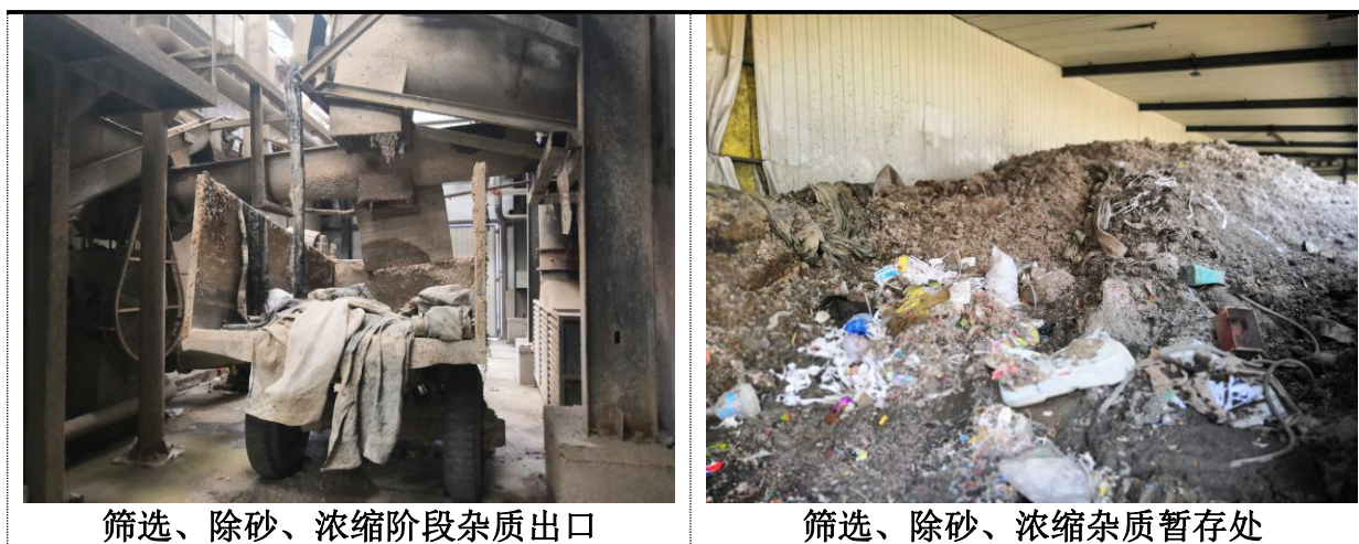
图 4.1-3 固体废物处置设施
