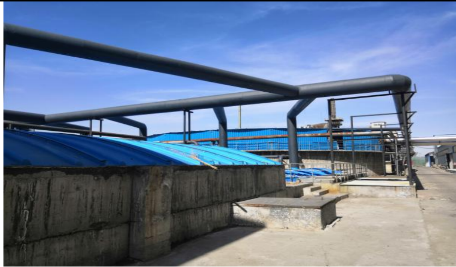
恶臭气体收集管道
