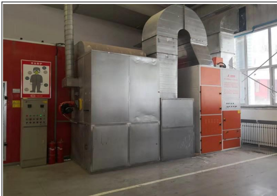
烤漆房废气处理系统
