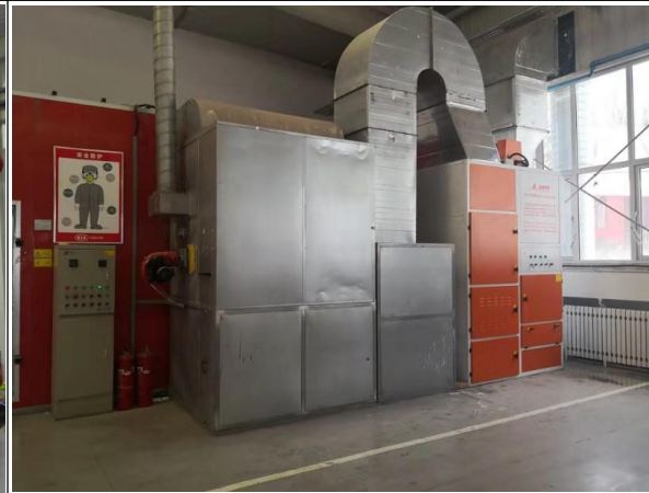
烤漆房废气处理装置
